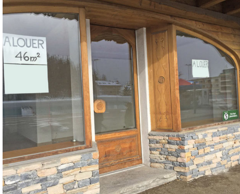
Les loyers trop chers ont eu raison de certains commerces de la station. L'ACCM et CMTC ont imaginé un intéressant projet pour réhabiliter les vitrines vides. PHOTOS BONVIN
