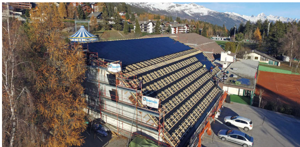
Les travaux d'étanchéité et de pose de panneaux photovoltaïques sur la partie ouest de la toiture du centre sportif de La Moubra se sont échelonnés de septembre à décembre 2016. PHOTOS ACCM
